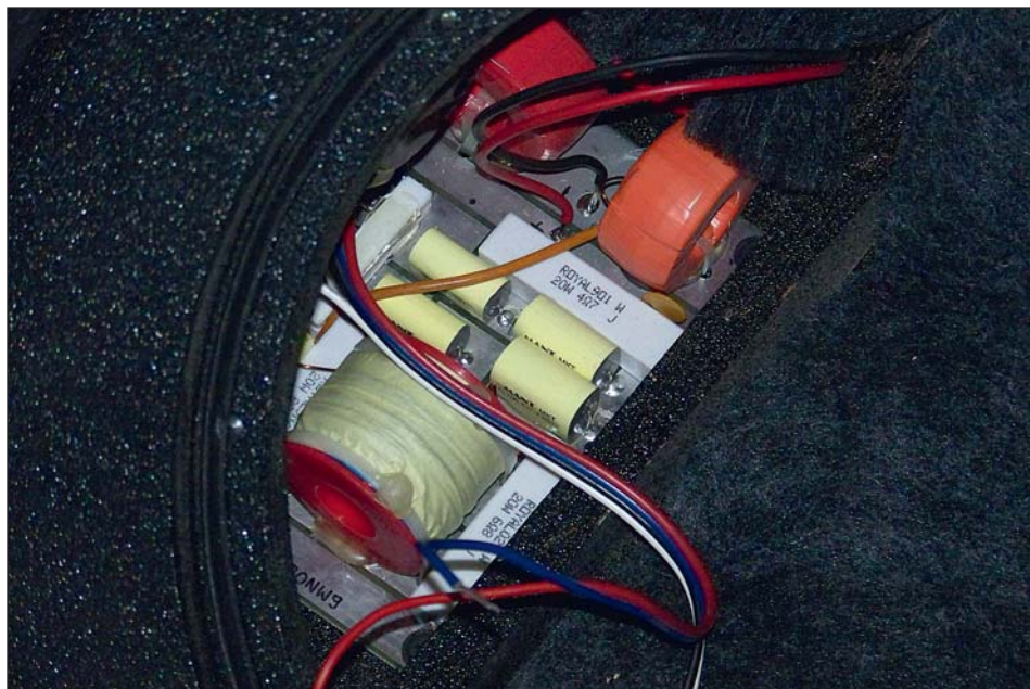
Montaż filtru RLC jest bardzo solidny i estetyczny, a połączenia lutowane są trwale i dobrze dograne.
